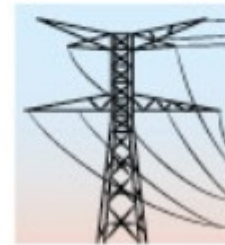
ligne haute tension
